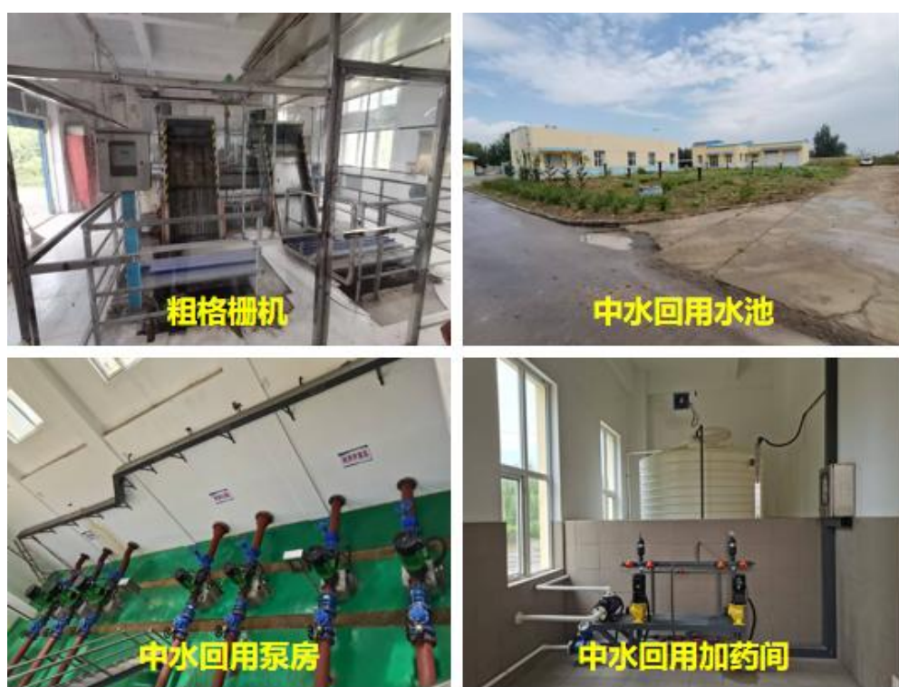
图 3-3 项目废水治理设施控制措施照片
