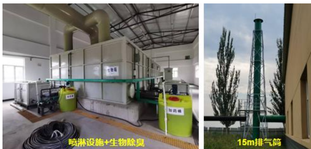
图 3-1 项目有组织恶臭气体治理设施控制措施照片
